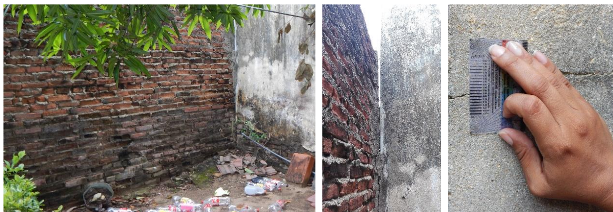
Figuras 75, 76 y 77: Muros de patio. Erosión por afectación del viento y lluvia sobre ladrillo de muro de cerramiento, que al parecer nunca presentó recubrimiento en pañete ni mucho menos pintura. Grieta por dilatación entre muro de cerramiento perimetral y muro divisorio. Fisura sobre recubrimiento en pañete de muro de patio.
