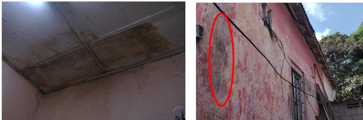
Figuras 71 y 72: Humedades y suciedades. Humedad por filtración (afectación generalizada) y suciedad por lavado diferencial en fachada lateral del inmueble. Fuente: Elaboración propia.
