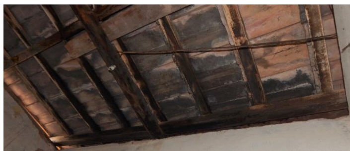
Figura 99: Ausencia de cielo raso. Estado general de cubierta en cocina, baño y depósito, los cuales no presentan cielo raso. Fuente: Elaboración propia.
