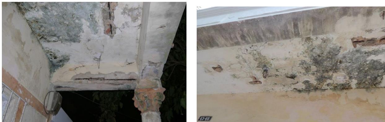
Figuras 73 y 74: Losa de terraza. Detalle de estado de conservación de losa de fachada. Fuente: Elaboración propia.
