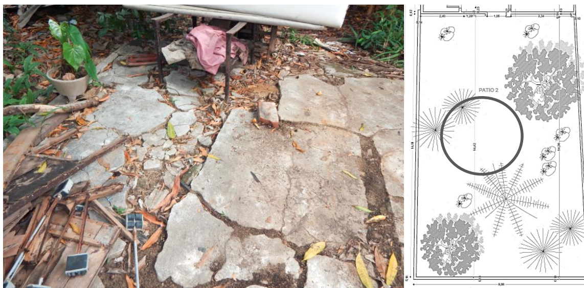
Figuras 103 y 104: Piso en patio dos. Detalle de estado de piso a nivel de patio dos, en zona señalada en plano. Fuente: Elaboración propia.
