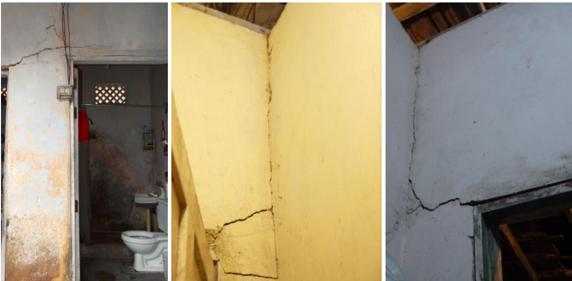
Figuras 87, 88 y 89: Grietas en muros de baño y cocina. Grietas pasantes en vanos de puertas de acceso que se desplazan hacia las intersecciones de los muros. Fuente: Elaboración propia.
