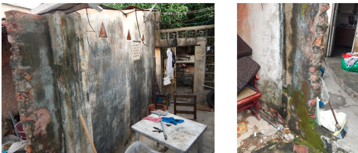
Figuras 93 y 94: Comunidades biológicas y humedades en muros. Estado general de muros frente a cocina y deposito. Fuente: Elaboración propia.
