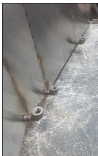
Ilustración 4 Adecuación de los Puntos de Aforo en la Canaleta.
