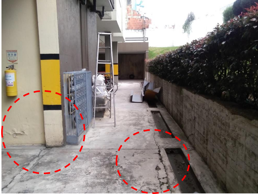
Ilustración 29 Fisuras en Placa de Contrapiso y humedad por capilaridad.
