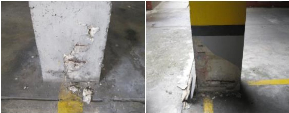
Ilustración 32 Lesiones en columnas desprendimientos y presencia de corrosión.
