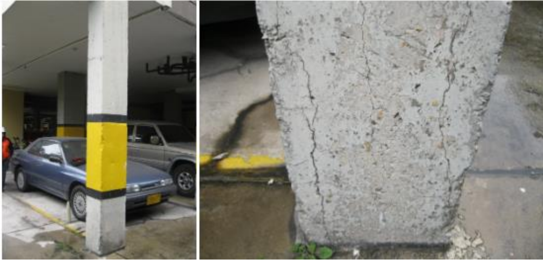
Ilustración 33 Lesiones parte inferior de columnas.
