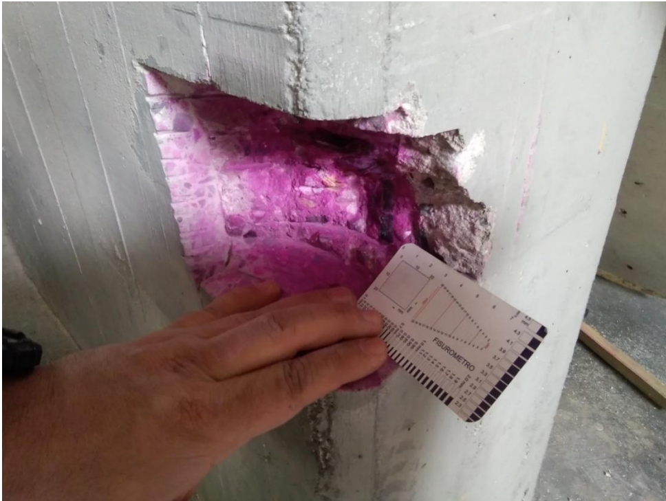
Ilustración 26 Frente de carbonatación avanzado cercano al acero de refuerzo.
