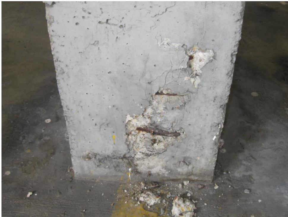
Ilustración 30 Desprendimiento del concreto.
