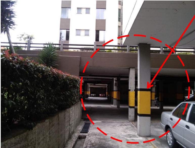
Ilustración 27 Columnas Expuestas y afectadas..
