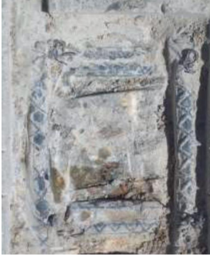
Figura 18. Regata en la losa de piso
