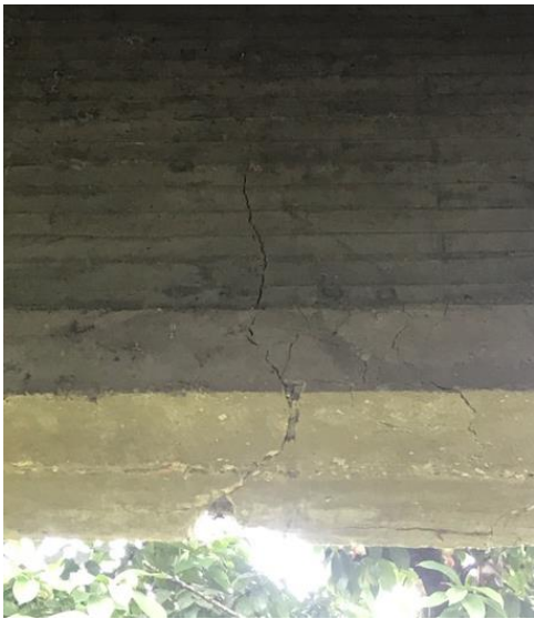
Figura 11. Grieta en la viga exterior en la zona central
