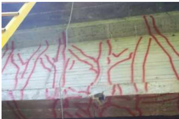
Figura 23. Fisuras y grietas en la viga 4D
