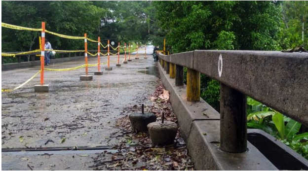
Figura 8. Deformación en la baranda por deformación en la viga exterior
