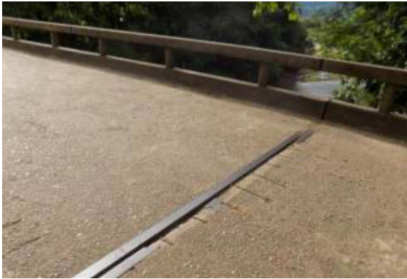
Figura 22. Falta de capa de rodadura
