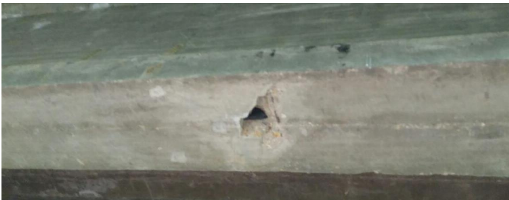
Figura 12. Desprendimiento de concreto en la viga exterior en la zona central
