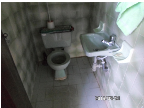
Vista unidad Sanitaria
