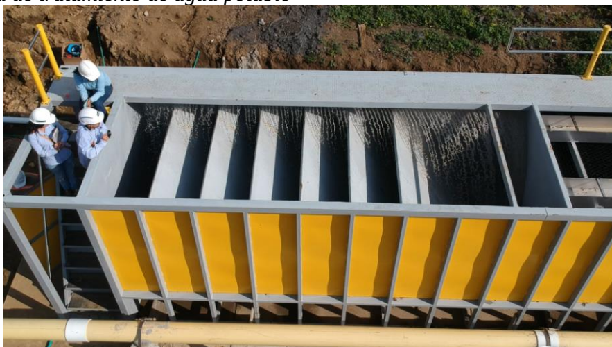
Figura 51. Planta de tratamiento de agua potable
