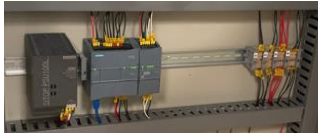
Figura 24. Ubicación del PLC, módulo de entradas analógicas y borneras auxiliares de 110v y 24v
