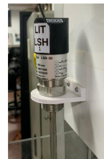
Figura 31. Sonda de nivel del tanque de agua del laboratorio
