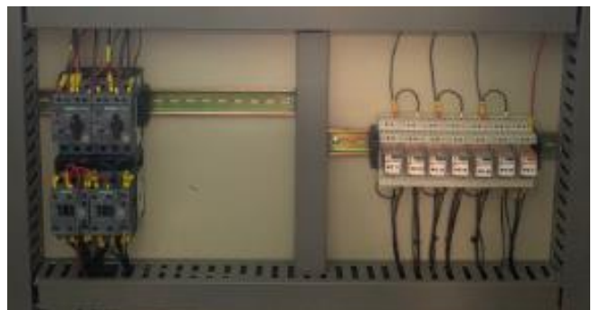
Figura 25. Ubicación contactores, guardamotores y relés
