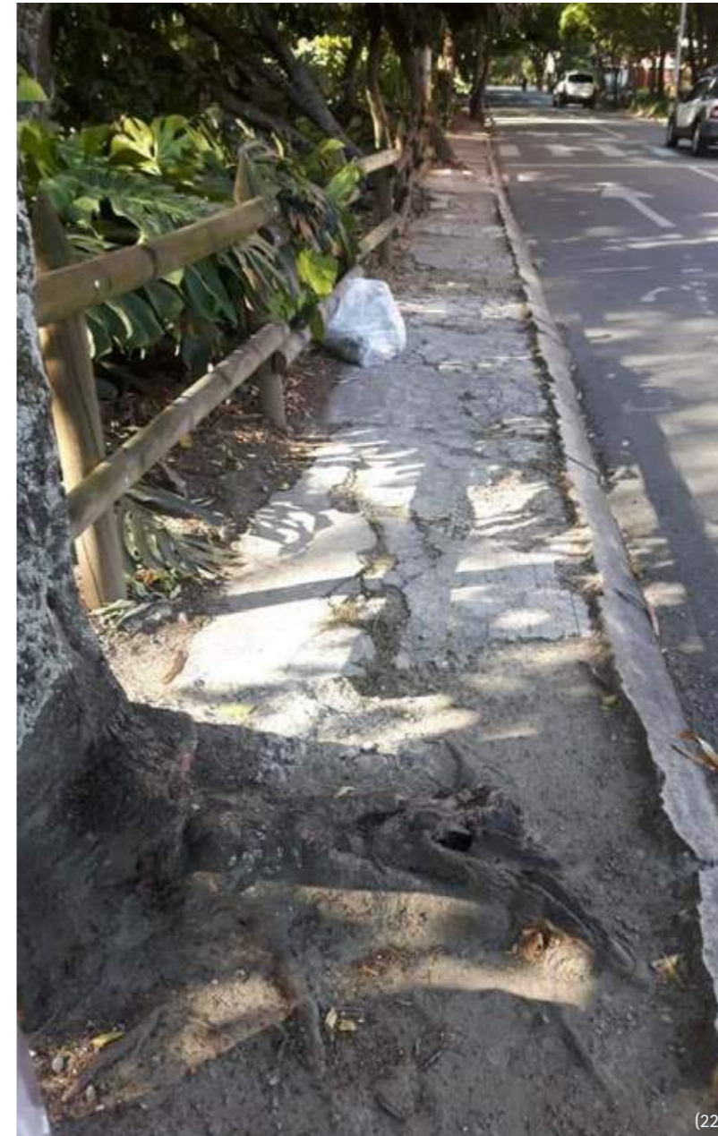
15, 22. Evidencia del deterioro de andenes sobre la quebrada Ana Díaz.
