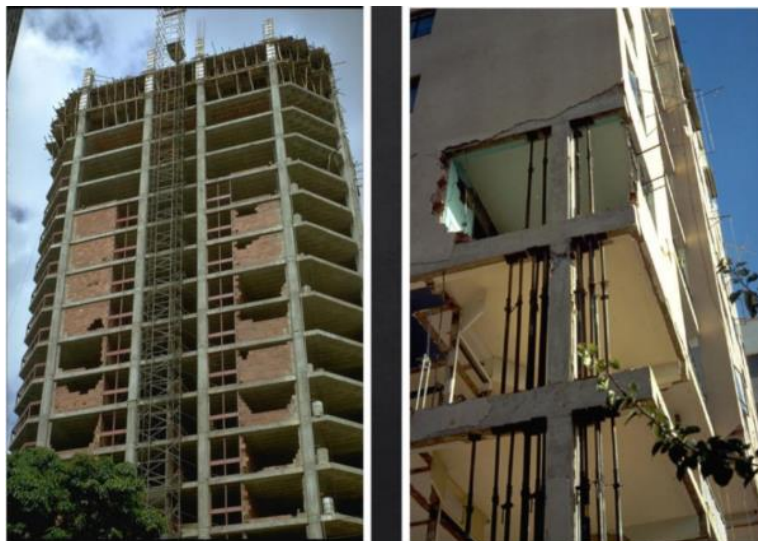
Ilustración 2: Daños en los Elementos No Estructurales de una edificación.
