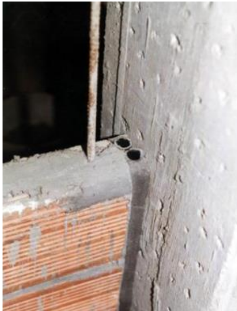
Ilustración 25: Mangueras embebidas en el mortero para la separación del muro de la estructura.
