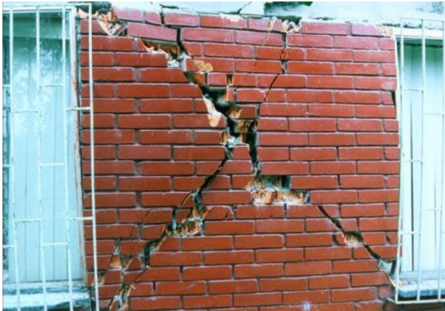
Ilustración 22: Muro colapsado apoyado en todos sus bordes
