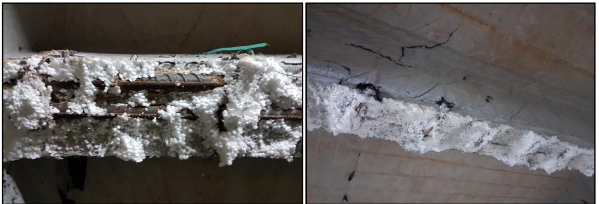
Figura 23. Exposición severa del acero de refuerzo de las vigas riostras. Fuente Propia
