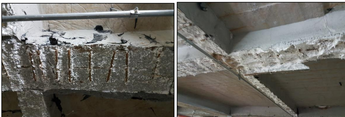
Figura 44. Exposición del acero que presentan las Vigas principales ejes 5 y 6 del sótano. Fuente propia.
