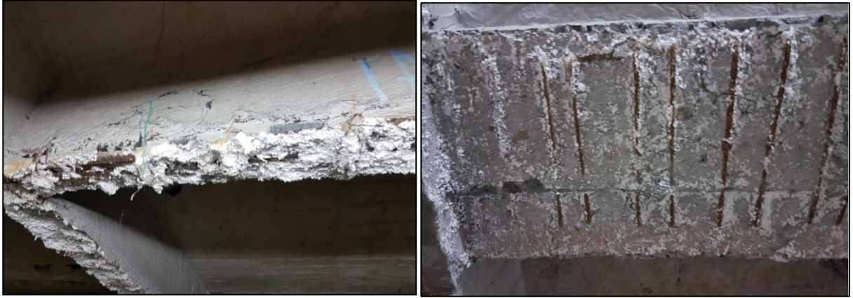
Figura 21. Estado Actual de las Vigas Riostras y Viga Principal del Eje 5 Fuente: Propia.
