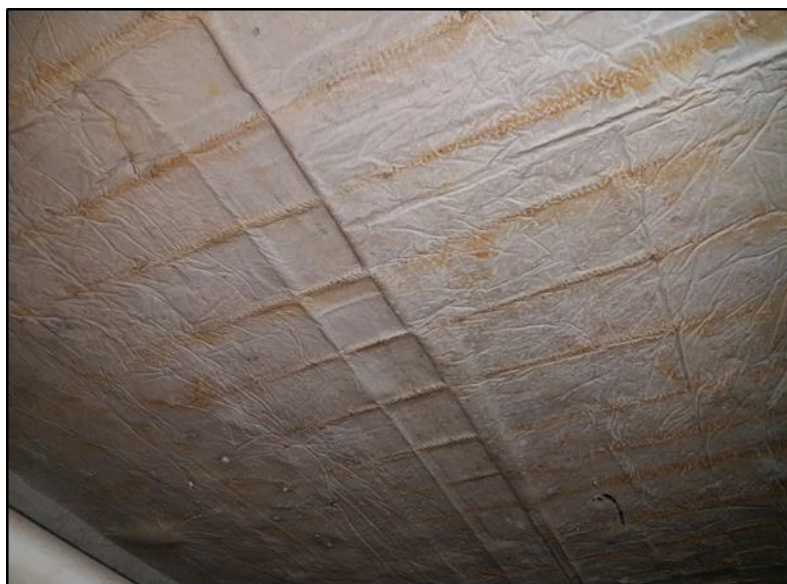
Figura 28. Losa de Concreto Entre Piso, Evidencia de Fallas en el Recubrimiento del Concreto. Fuente: propia.
