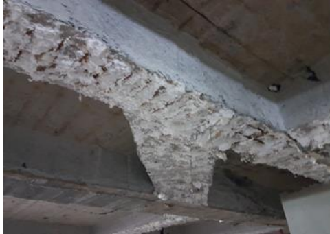
Figura 42. Superficie inferior de los elementos con exposición del acero de refuerzo. Fuente propia
