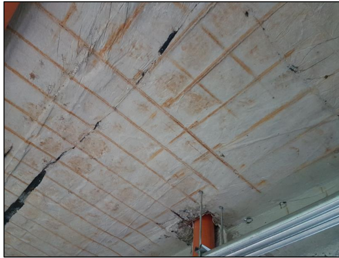
Figura 46. Estado de la losa de concreto entrepiso posterior a su desencofrado. Fuente propia.
