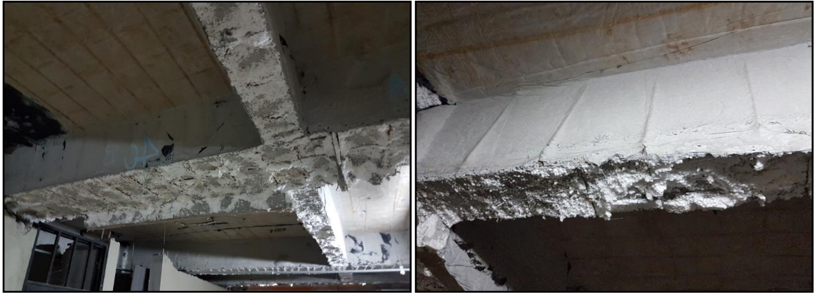
Figura 24. Evidencia de la falta de recubrimiento al acero de refuerzo en las vigas riostras y parte inferior de la placa entrepiso del parqueadero. Fuente Propia.
