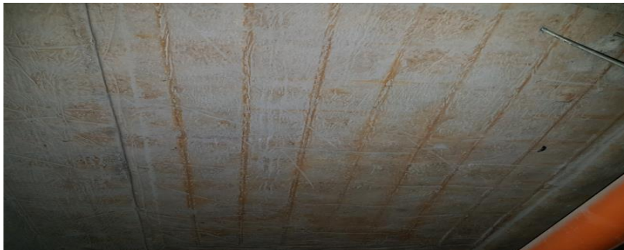
Figura 43. Falta de recubrimiento del acero de refuerzo en la losa entrepiso. Fuente propia.
