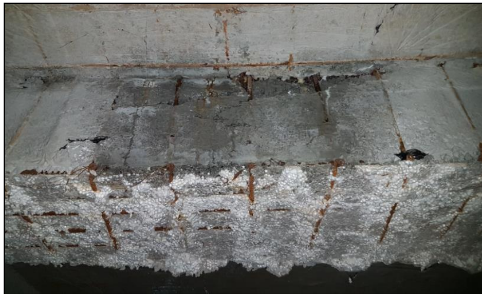
Figura 27. Exposición del acero de refuerzo de la viga principal y riostra del Eje 6 de la estructura. Fuente: Propia
