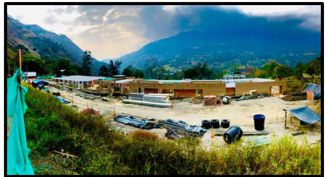
Fotografía 16. Panorámica Centro de Control Operacional Concesión Transversal del Sisga. Fuente: Autor.
