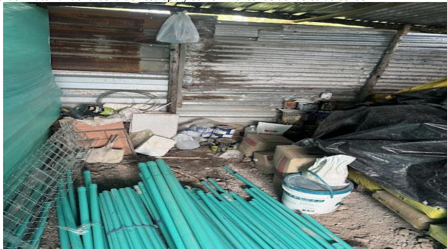
Figura 1 Evidencia del material de la obra de restrepo y son similares las de las otras obras
