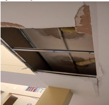
Figura 36 Cielo en mal estado fuente Dirección CDI
