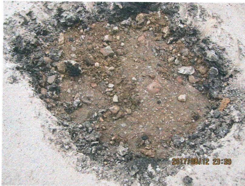
Apique # 2 Tramo medio. Se observa el escurrimiento y lavado de los agregados.
