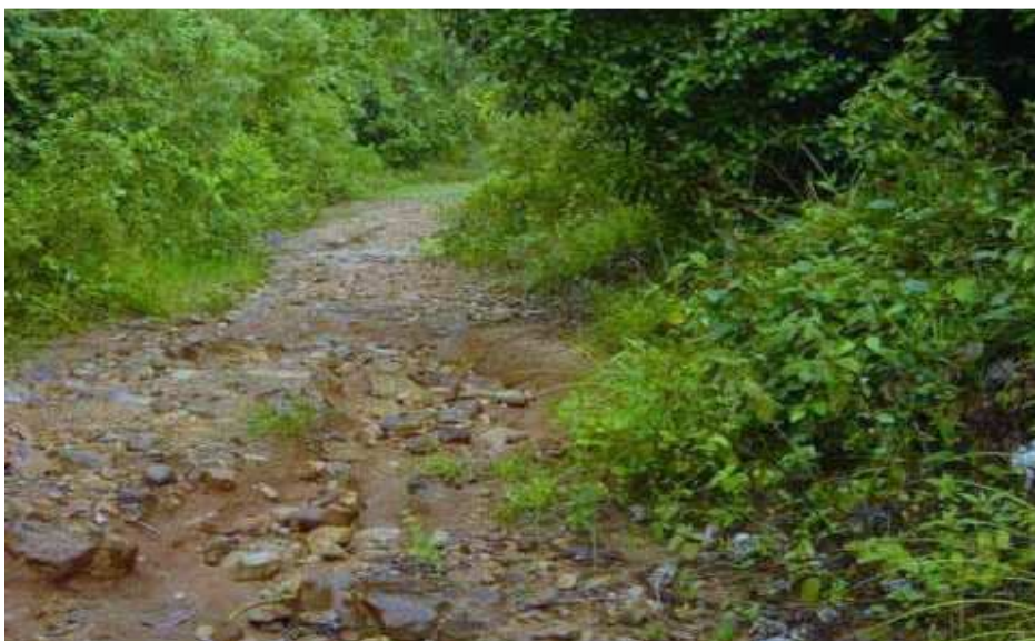
Fotografía No 14 – PM4 – Erosión por practicas inadecuadas de manejo del suelo
