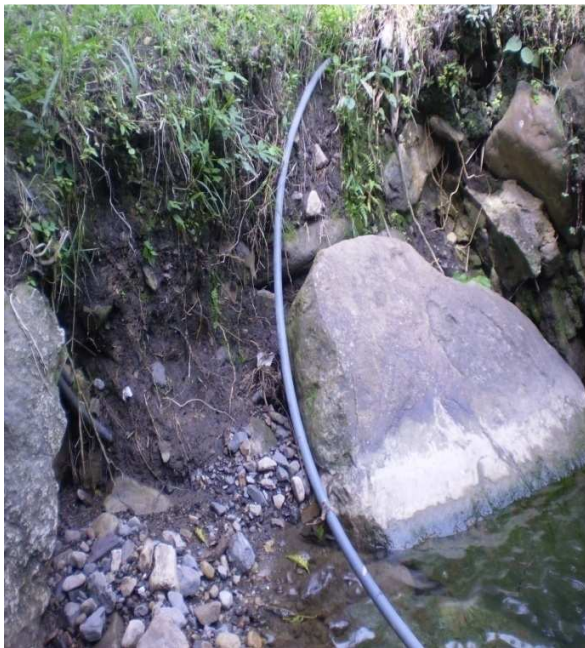
Fotografía No. 9 del punto PM2 (problemas Por erosión lateral márgenes de la quebrada).
