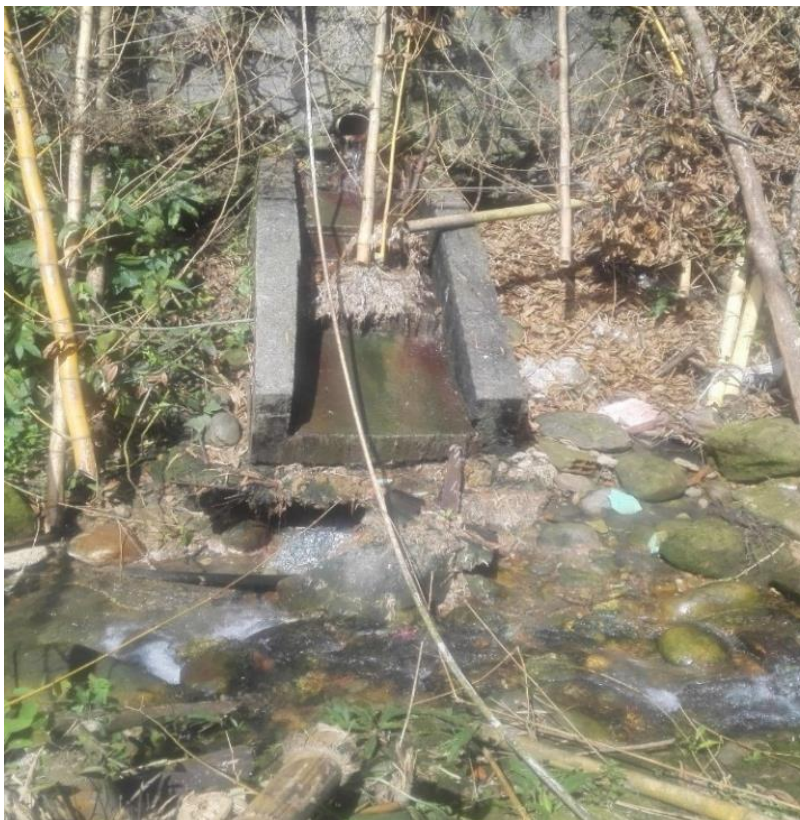
Figura 3 Salida del vertimiento de PROCEAVICOLA donde se evidencia residuos de plumas y demás. Fotografía tomada por: Lorena Martínez, 2019
