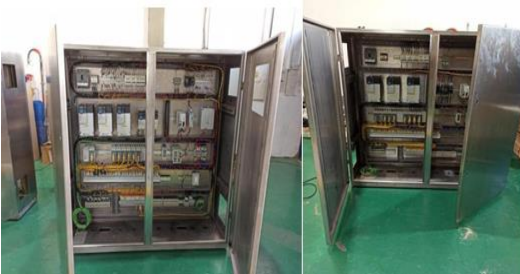
Figura 5. Tableros de control clúster mezclas y silos
