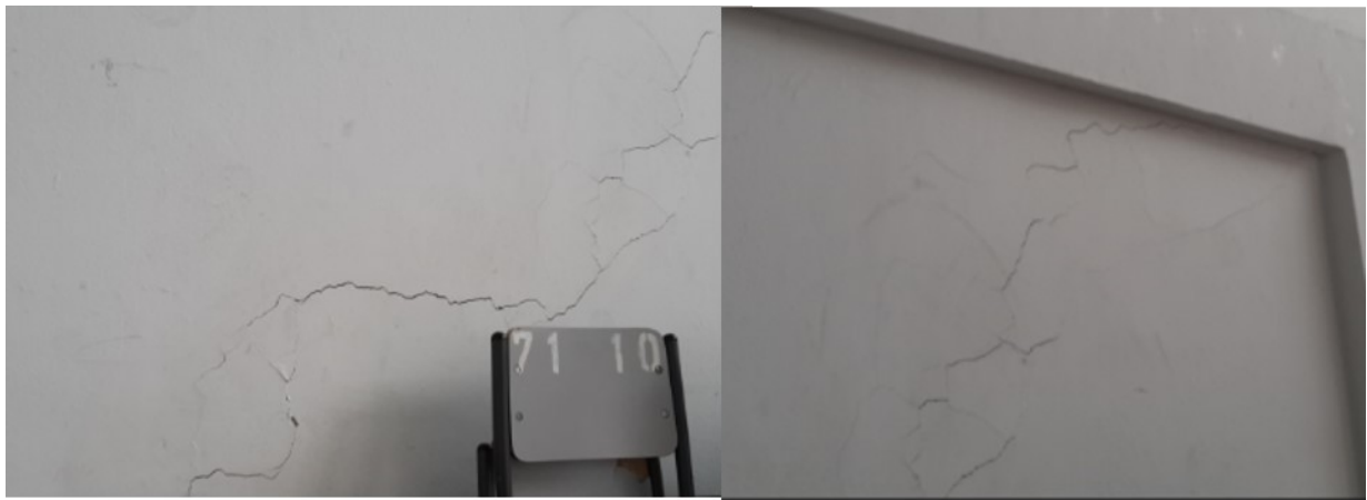
Figura 5: Fisuras por asentamientos. Fuente: Propia
