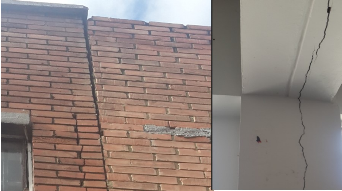
Figura 6: Fisuras por asentamientos. Fuente: Propia
