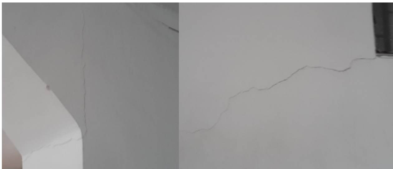
Figura 7: Fisuras por esfuerzos en puerta y ventana. Fuente: Propia
