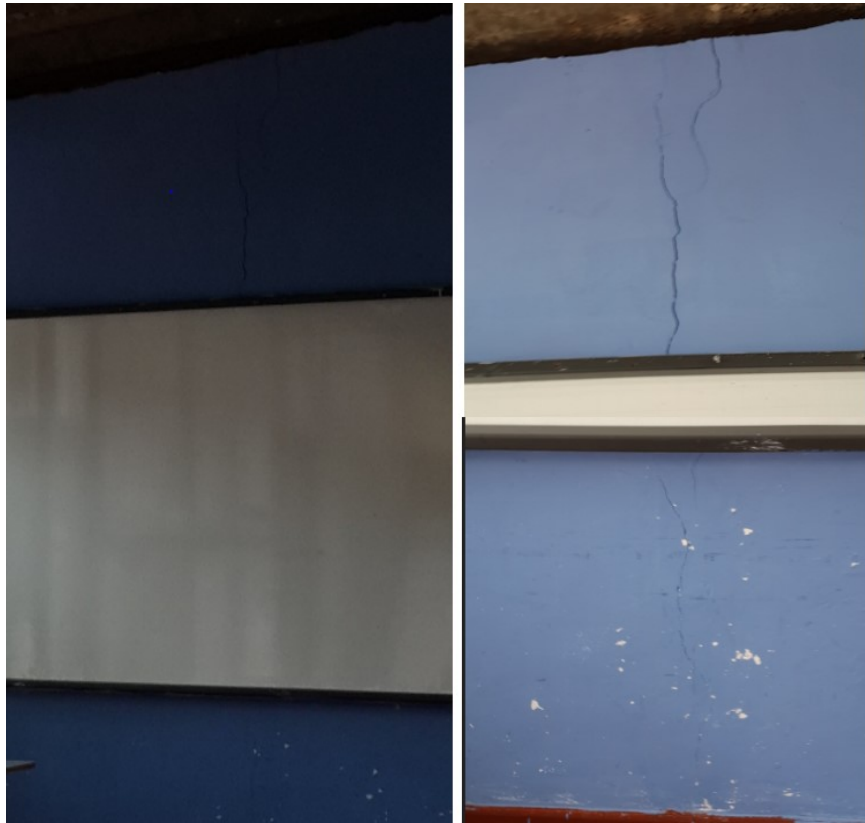
Figura 14: Fisura encontrada dentro del salón. Fuente: Propia
