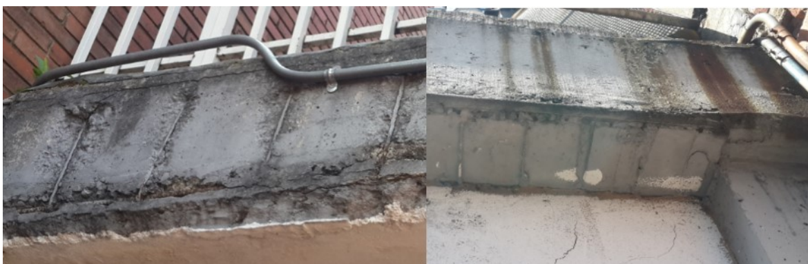
Figura 12: Eflorescencias en la parte inferior del muro. Fuente: Propia
