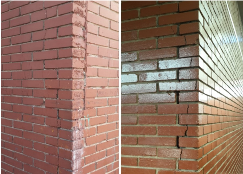
Figura 2: Fisuras por empuje entre muros. Fuente: Propia
