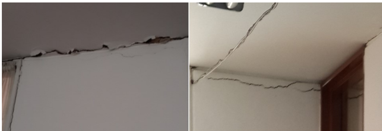
Figura 3: Fisuras por retracción. Fuente: Propia
