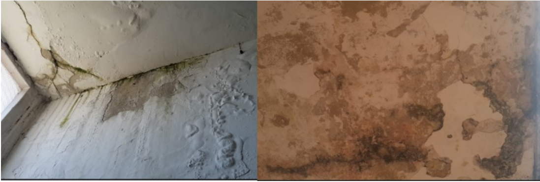
Figura 10: Humedades por filtración en cubierta. Fuente: Propia
