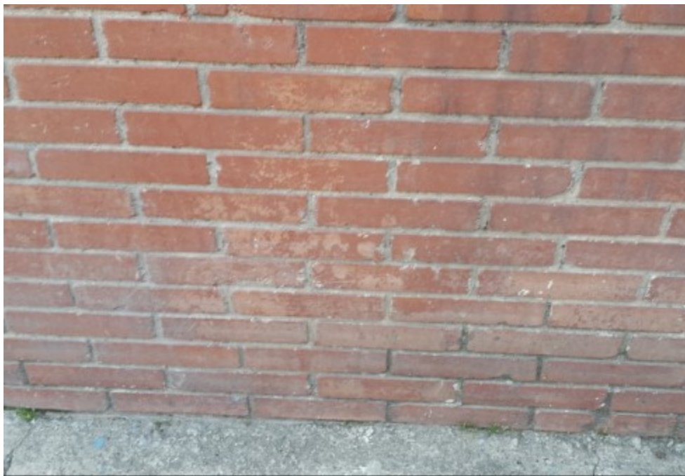
Figura 11: Eflorescencias en la parte inferior del muro. Fuente: Propia
