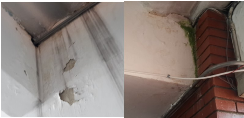
Figura 9: Humedades por filtración. Fuente: Propia
