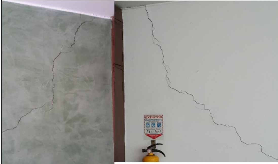
Figura 4: Fisura diagonal por asentamientos. Fuente: Propia
