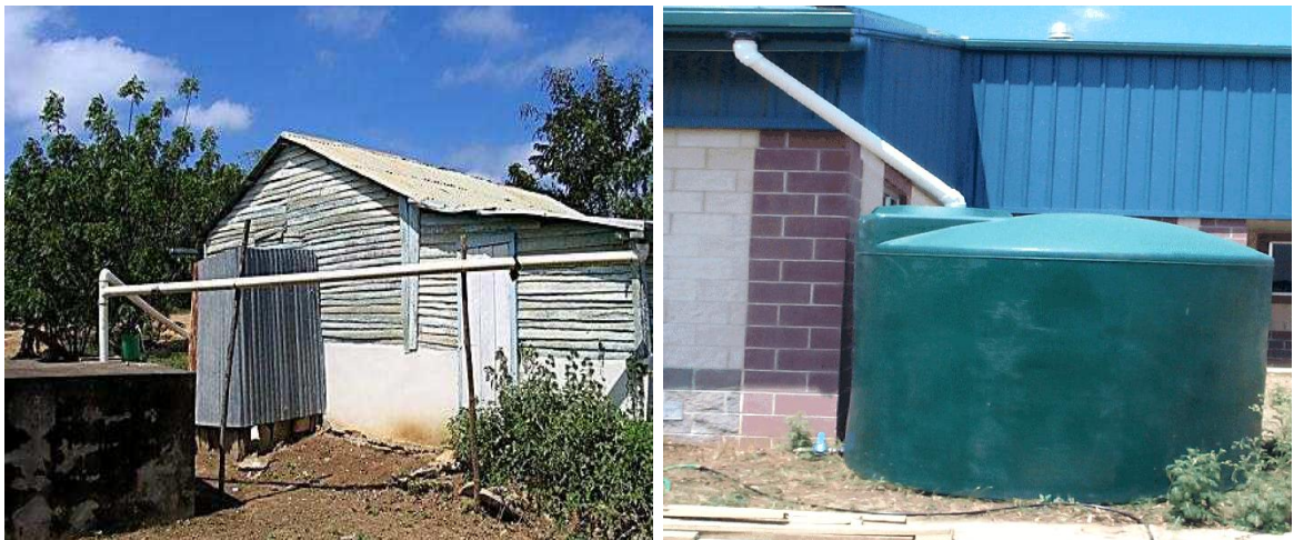
Figura 24: Sistemas de captación económicos construidos con ayuda de ONG's.
