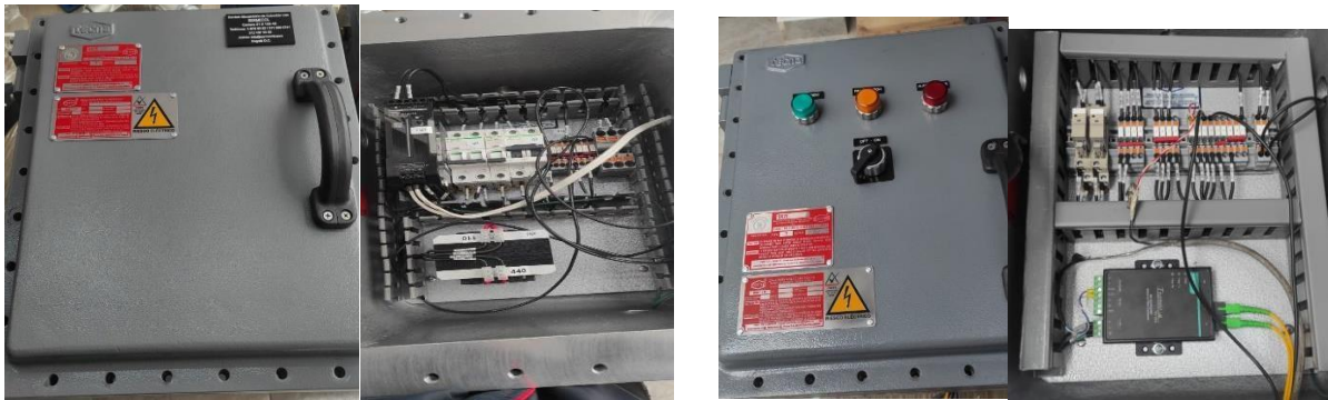
Figura 7. Cajas a prueba de explosión, circuito de potencia y de control
