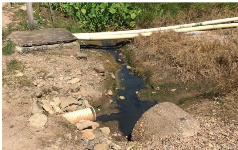
Figura 17. Descarga en terreno baldío barrio San Jorge Fuente: Autor
