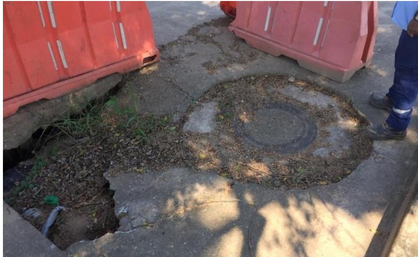
Figura 11. Pozo 479 Transversal 20 Barrio 20 de Julio Fuente: Autor
