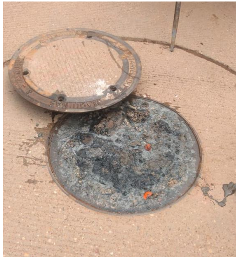
Figura 1. Colmatación pozo de inspección 551, Barrio el Modelo Fuente: Autor
