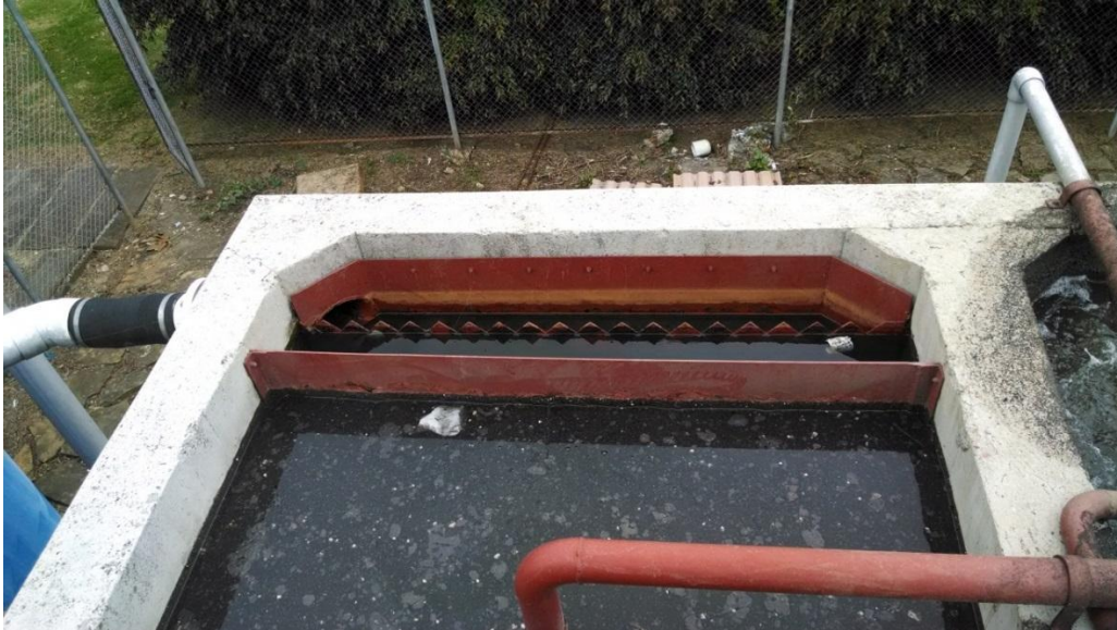
Foto 5. Tanque Sedimentador. Fuente: Los autores
