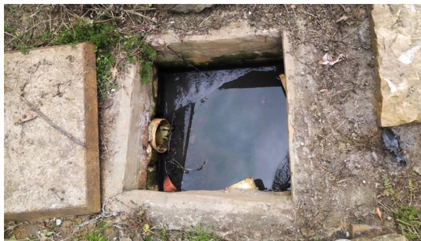
Foto 8. Caja de inspección de salida. Fuente: Los autores
