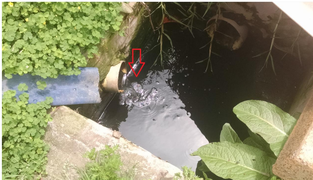
Foto 13. Salida al alcantarillado. Fuente: Los autores
