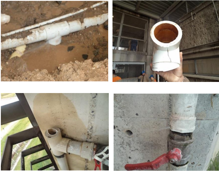
Figura 8. Fallas y Rupturas por Presión.
