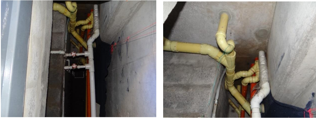
Figura 9. Ductos Internos Áreas Comunes.
