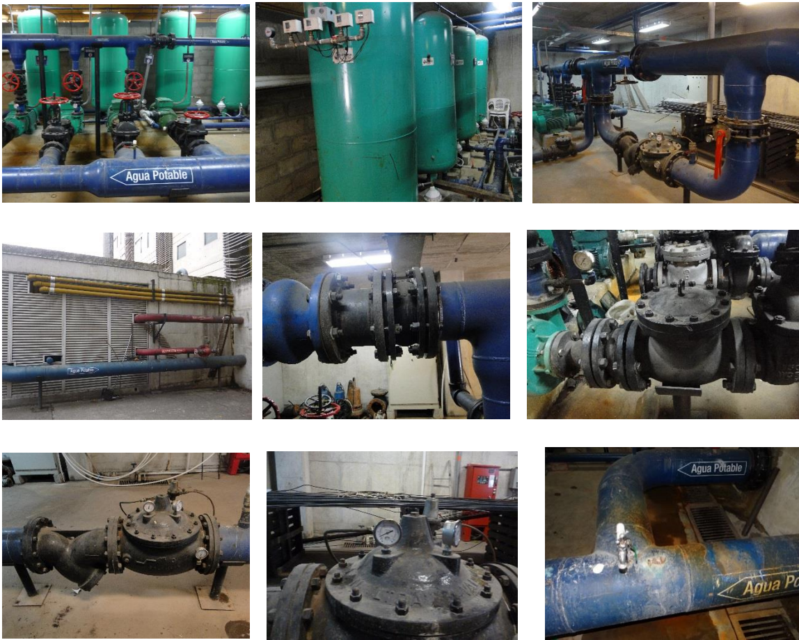
Figura 5. Cuarto de Moto Bombas.
