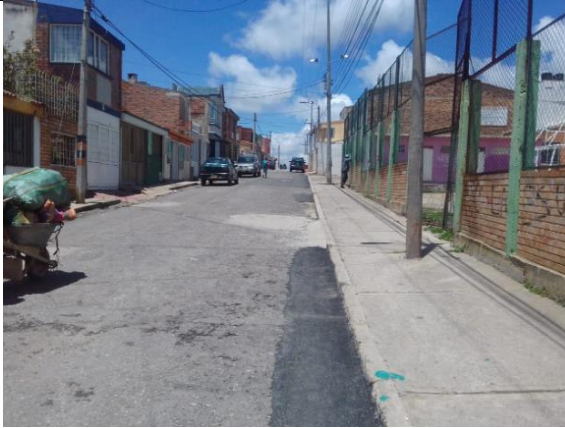
Ilustración 14. Reparchoo vía Barrio Paraíso.
