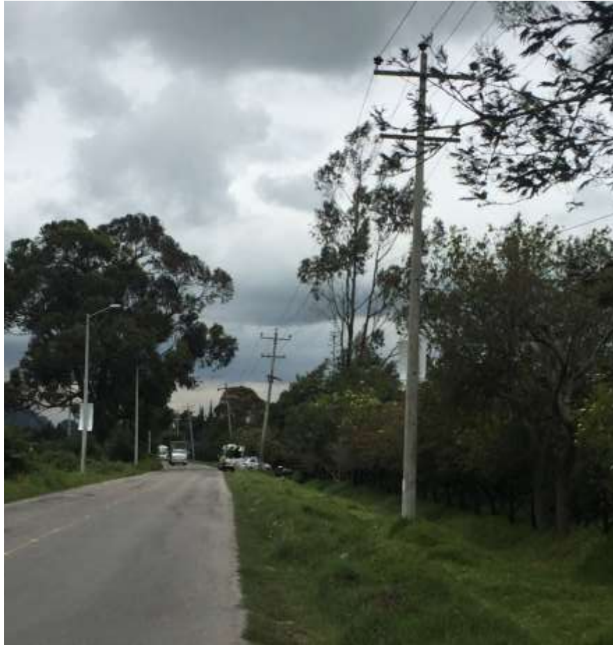
Figura 2,27. Postes eléctricos inclinados por fallas en el suelo de emplazamiento (Autor).
