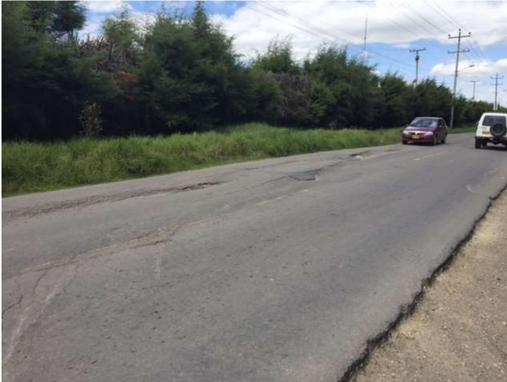
Figura 2,22. Hundimiento de secciones de pavimento de vía pavimentada (Autor).
