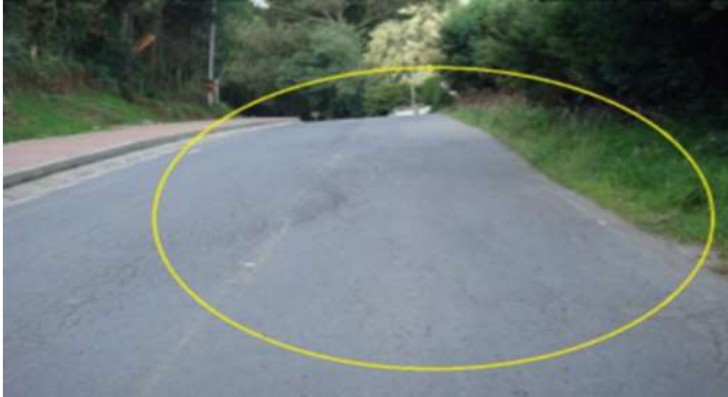
Figura 4,13. Falla por Abultamiento ocurrida en la región de la Sabana de Bogotá (Rueda 2012)
