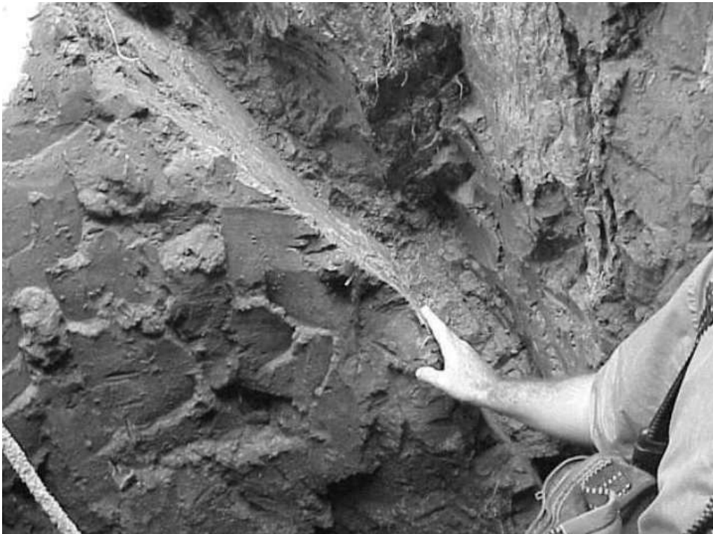
Figura 3,9. Fracturas en suelos arcillosos (Vesga, Meza y Caicedo, 2003).
