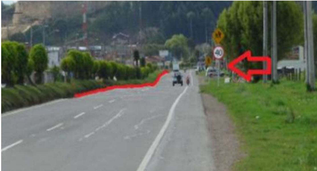
Figura 4,12. Falla por Hundimiento de una región de vía (Rueda 2012).
