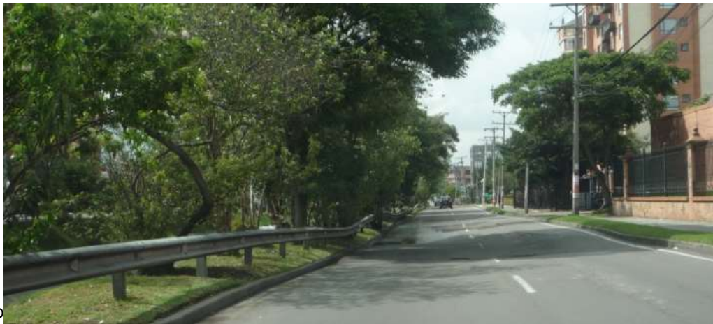
Figura 2,19. Asentamientos diferenciales de calzada de vía en Cra 19 en la ciudad de Bogotá (Autor).
