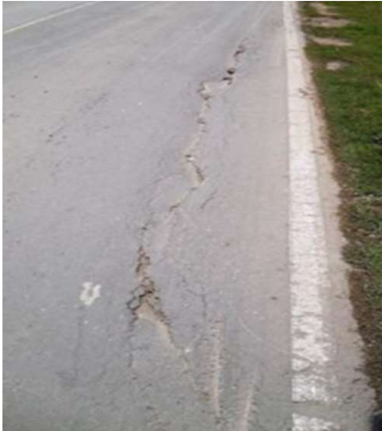
Figura 4,11. Fisura de Borde en Pavimento sin Berma (Rueda 2012).
