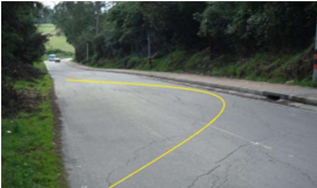
Figura 4,10. Falla de Pavimentos en Media Luna (Rueda 2012).
