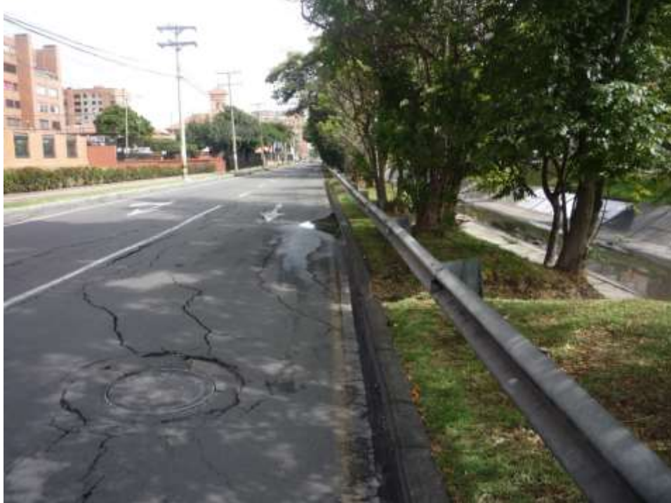
Figura 2,24. Asentamientos diferenciales producidos por pérdida de humedad ligada a la succión de las raíces de los árboles (Autor).
