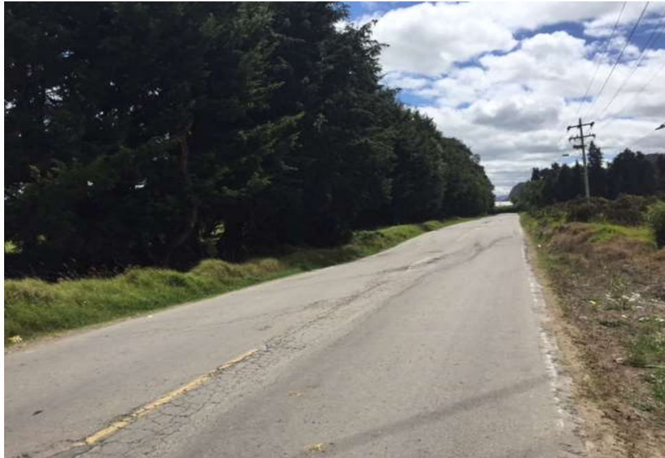
Figura 2,21. Hundimientos en vías por asentamientos diferenciales de la estructura (Autor).
