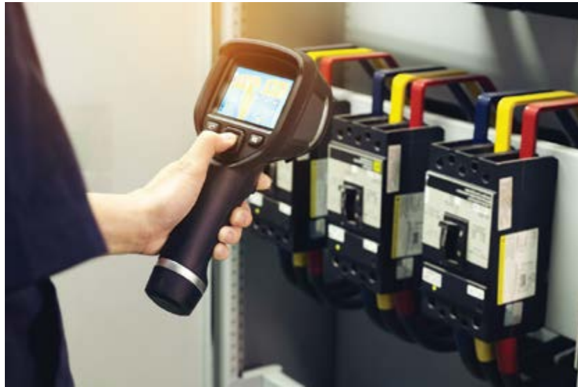
Figura 25. Análisis termográfico de un interruptor.
